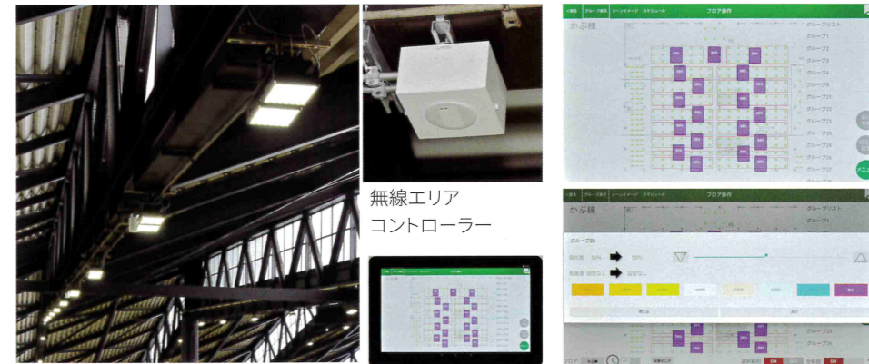
鉄骨トラスに設置された無線T/FlecsシステムLED高天井器具① 無線エリアコントローラー タブレット操作器 タブレット操作画面
